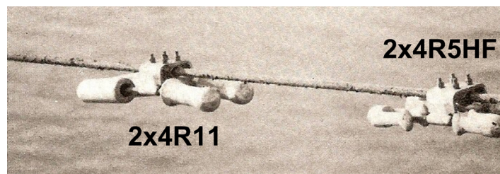
Figura 13 - Ammortizzatori di vibrazione tipo Stockbridge usati nelle campate della tratta di attraversamento e loro distribuzione sui conduttori.
