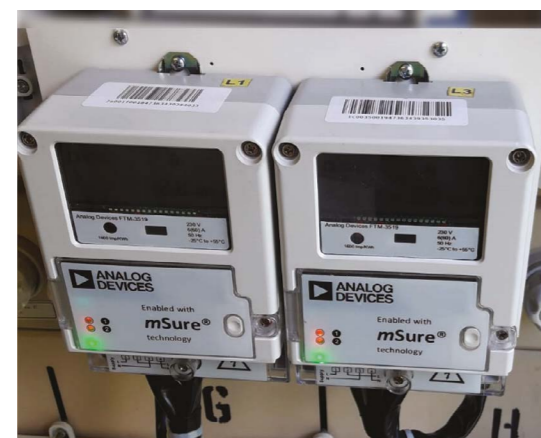
Figura 1 - Dispositivi pilota installati sul campo.
