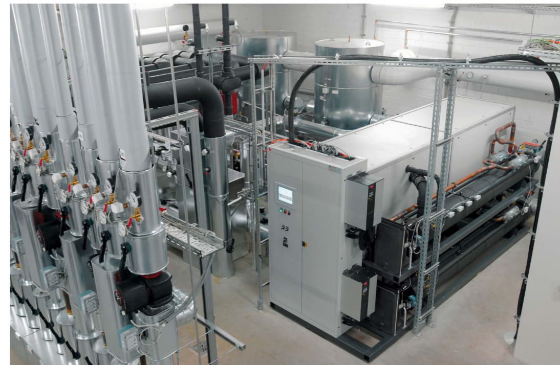
Figura 1 - Pompa di calore installata in centrale termica. Gli edifici di nuova costruzione, connotati da una elevata classificazione energetica, vengono ormai progettati prevedendo il ricorso alle pompe di calore.
